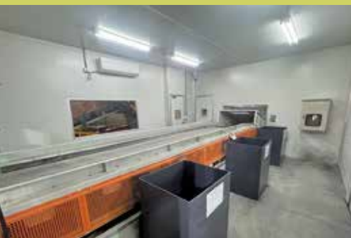
▲廠房設備-人工撿拾臺。
